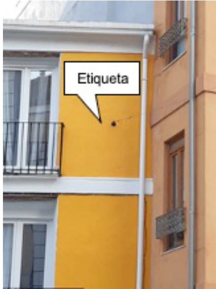
Figura 12.2. Gancho y cable que sujeta la catenaria de tranvía.
