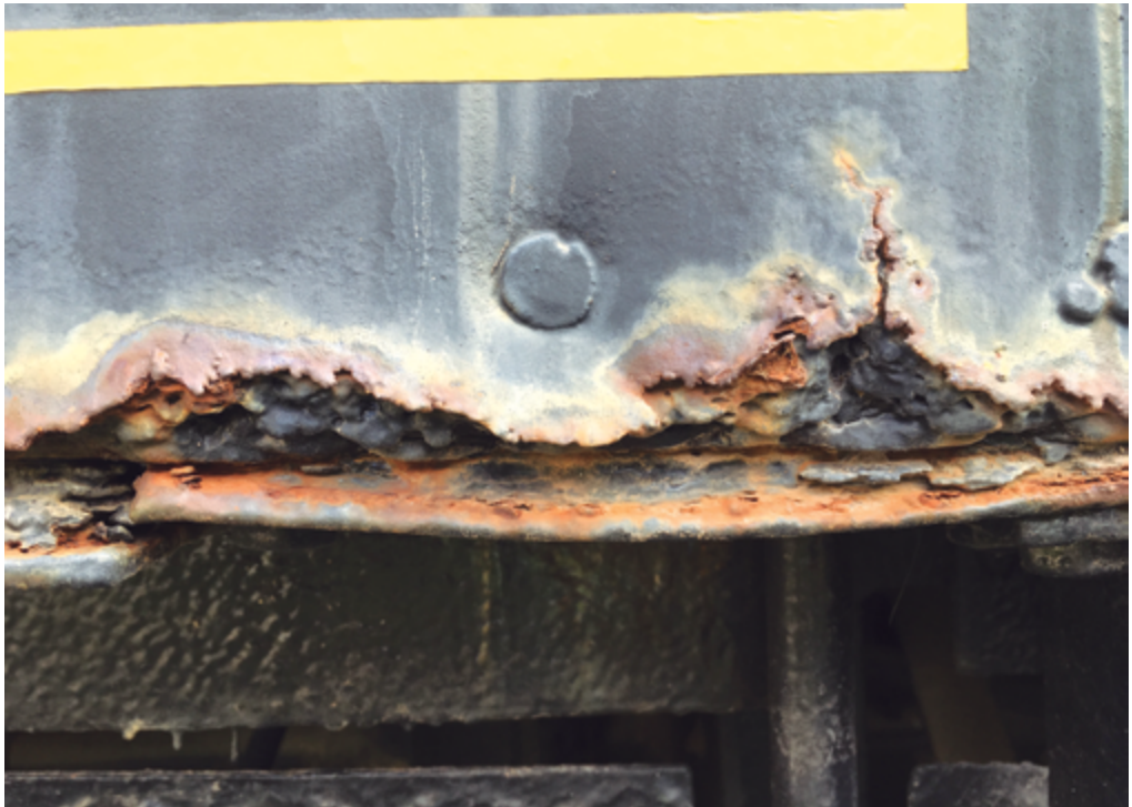
Figura 1.5. Erosión y desgaste de la pintura de la cabina, antes de su intervención restaurativa. Martín, S. (2019).
