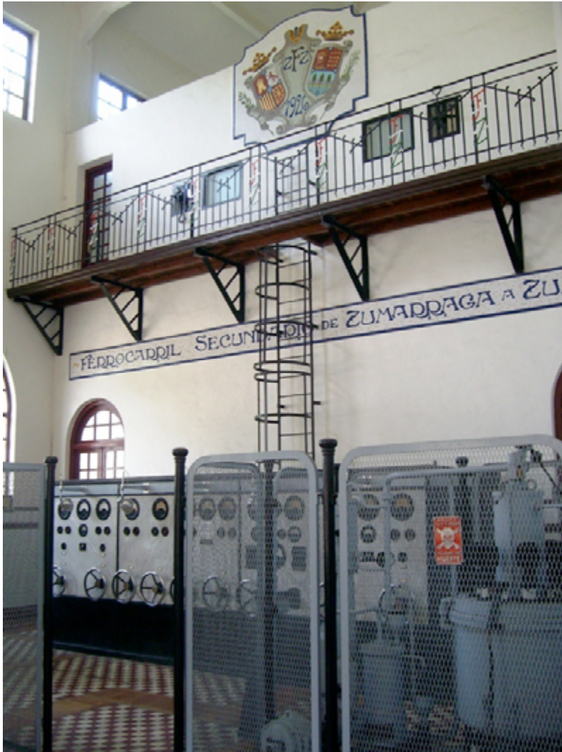
Figura 12.10. La subestación de tracción conserva los equipos de transformación y rectificación originales. Fotografía de Juanjo Olaizola Elordi.
